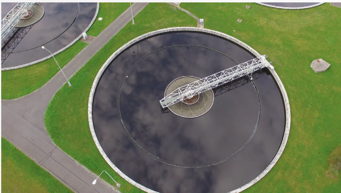
IMAGEN 17. Estación depuradora de aguas residuales. Fuente: fondo documental del Organismo.
